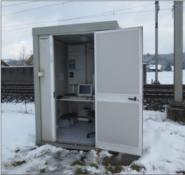
Abb. 67: Container mit Messtechnik an der Strecke bei Wichtrach
